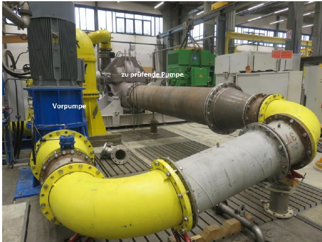
Abbildung 2 Prüfstands Aufbau Pumpentyp ZMK
