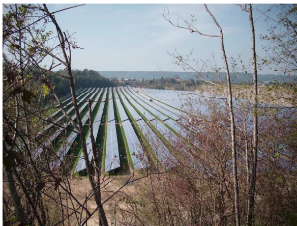
Abb. 22: PV-Anlage Woringen fotografiert vom östlichen Kiesgrubenrand
