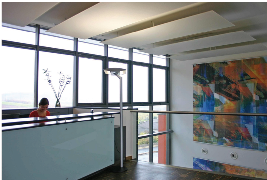
Abbildung 8 Deckenkühlsegel (Quelle: http://zent-frenger.de/fileadmin/medienpool/gfx_content/Gebaeudetemperierung/Segell%C3%B6sungen/MFE/MFE_Segel_1.jpg )
